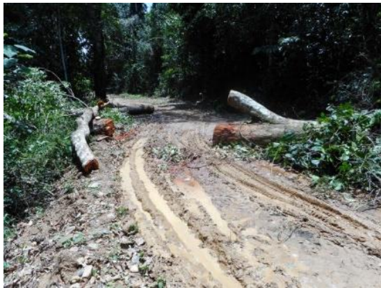
写真 1-3 風雨の後で道路を塞いだ倒木を切断して通行を確保
